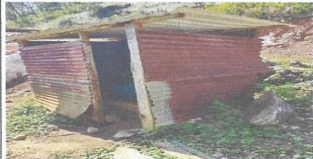
Foto 6: Se observa el único baño del centro educativo, se encuentra en mal estado.
