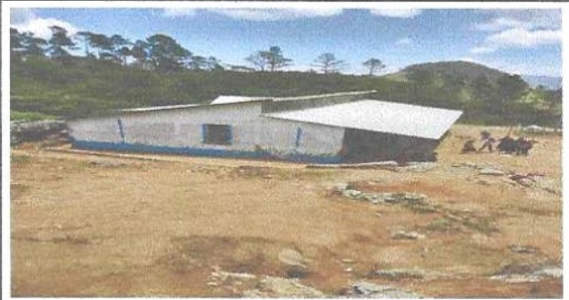
Foto 4: Se observa el desprendimiento de pintura en las paredes del módulo III.
