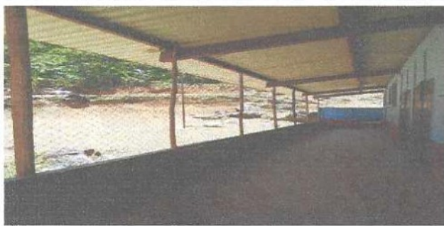
Foto 5: en esta fotografia se observa el deterioro del piso modulo IV.
