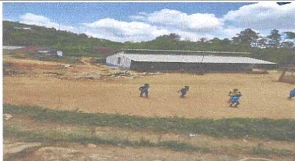
Foto 3: Modulo IV necesita rehabilitacion de cubierta.
