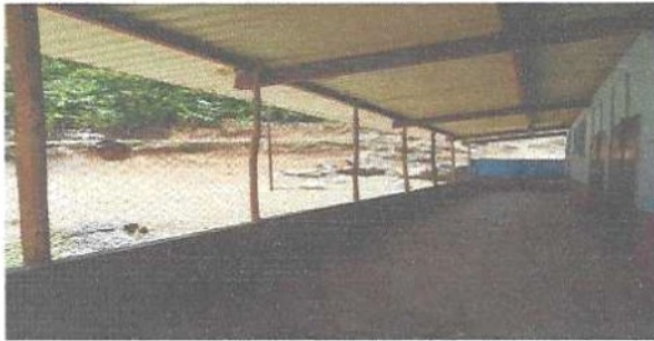
Foto1: foto 1: Corredor del módulo III, piso en mal estado.
